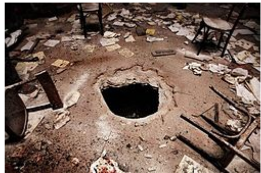
Das durch die Bombe entstandene Loch im Boden.
